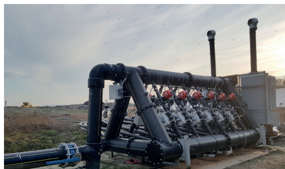
GAS STABILIZER presso una discarica marchigiana
