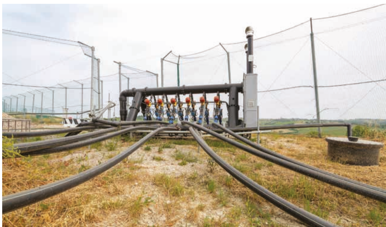
GAS STABILIZER PRESSO ASET SPA DISCARICA FANO
